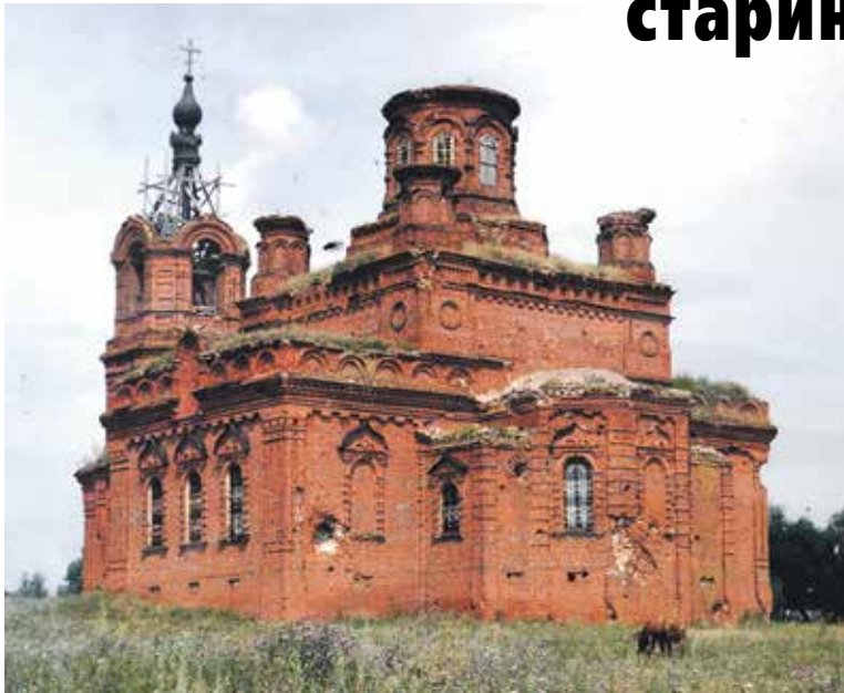
Так выглядел храм в начале реконструкции, к 2004 году на колокольне сохранился лишь накренившийся крест. Прихожане выравнивали его с помощью крана
