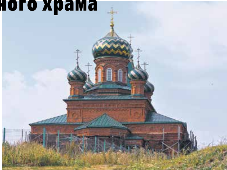
Восстановительные работы ведутся строителями сверху вниз: сначала была отремонтирована зиявшая дырами крыша, затем по кирпичикам восстановлены купола и стены, установлены окна. На сегодняшний день бригада реконструирует колокольню и входную группу
