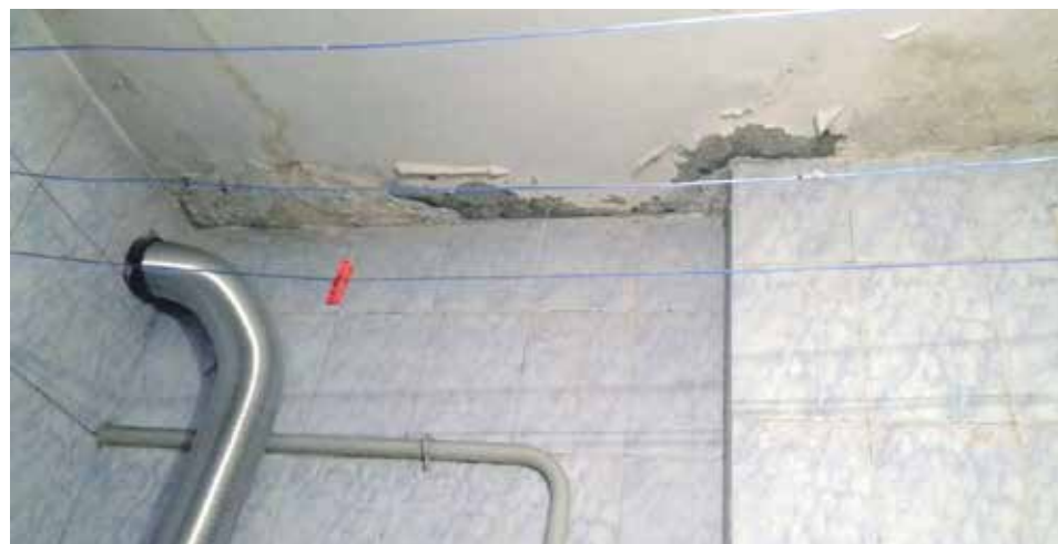
В ванной на голову сыплется штукатурка
