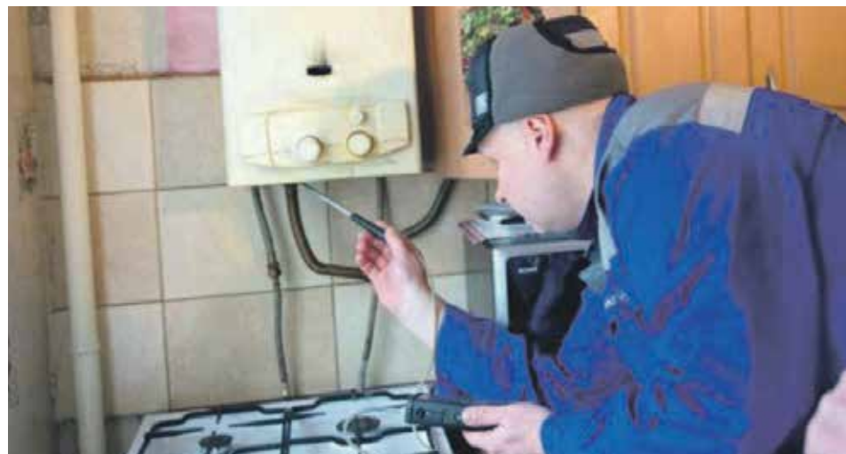
В перечень работ по капитальному ремонту общего имущества в многоквартирных домах входит техническое диагностирование внутридомового газового оборудования со сроком эксплуатации более 30 лет
