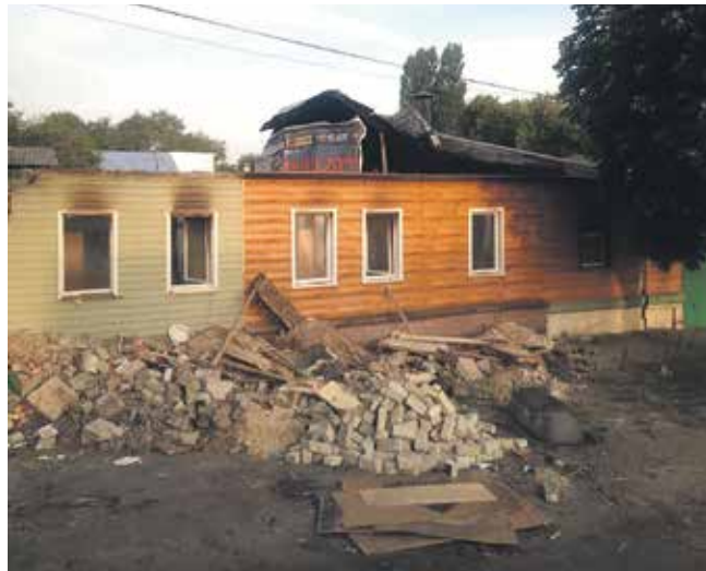
Огонь почти полностью уничтожил дом, сохранилась только лицевая сторона
