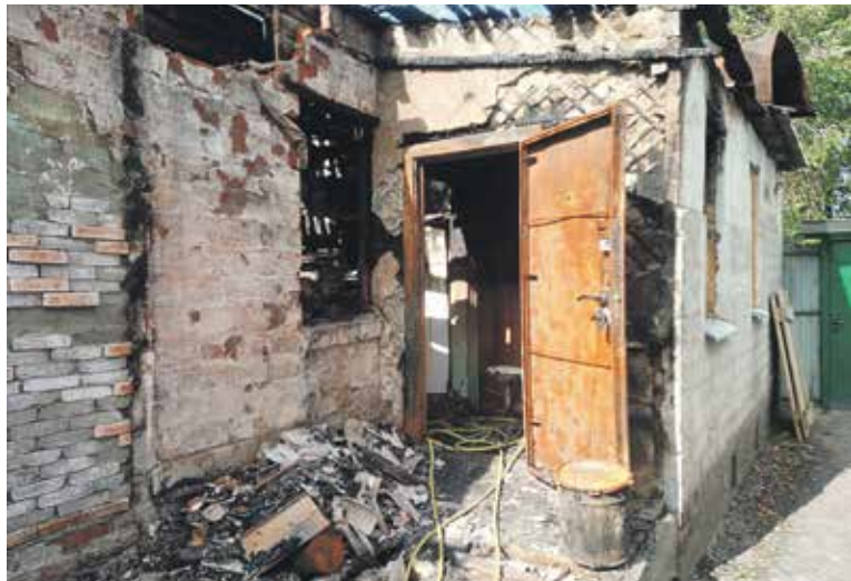
Глава семьи планировал постепенно ремонтировать родительский дом, но не ожидал, что понадобятся капитальные работы
